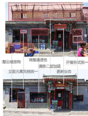
综合整改范例3
