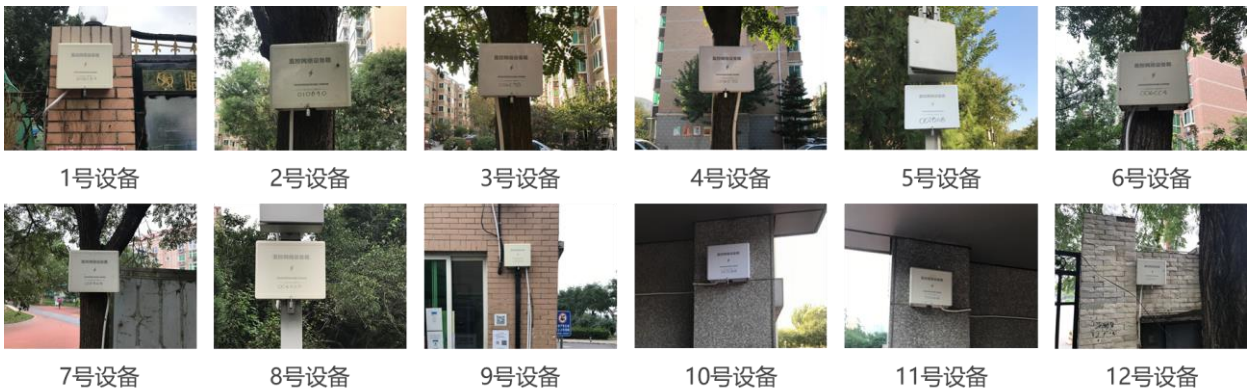
WiFi探针安装情况
